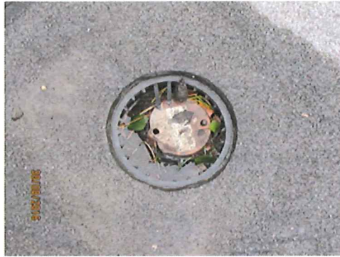
Kuva 8. Kattokaivosta puuttuu roskasiivilä.
