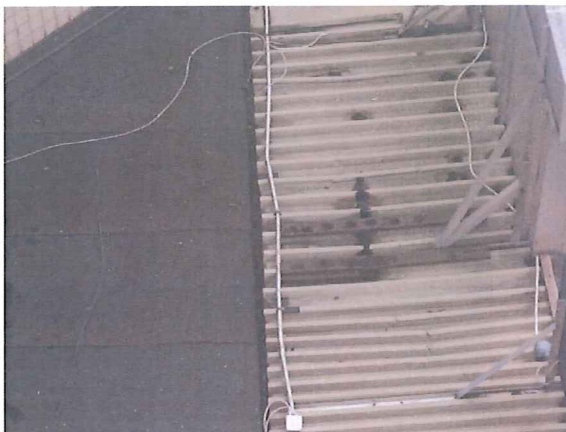
Kuva 21. Kattolippojen vedenpoistokouru krmikatteen ja profiilipellin yhtymäkohdassa.
