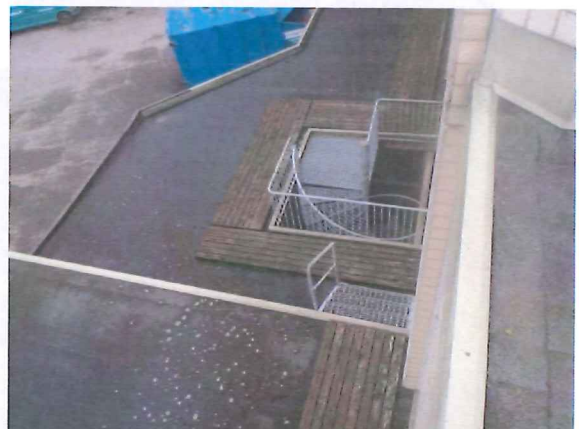
Kuva 24. Katolle johtavat kierreportaat, portaikot ja kulkusillat. Katolla on sammalta ja jäkälää.
