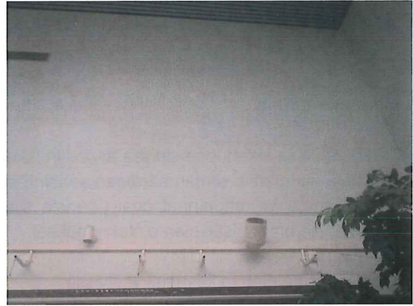
Kuva 28. Teknisen tilan seinällä on portaikon kohdalla tiiliseinän halkeilua.
