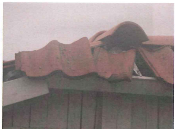
Kuva 26. Kattoterassin rikkoutunut tiilikatto.
