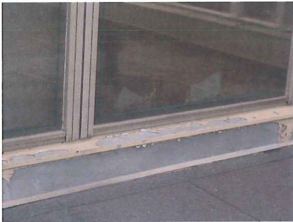
Kuva 13. Ikkunan vesipeltien maalipinnat hilseilee.
