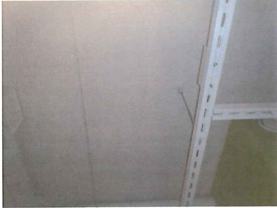
Kuva 31. Kampaamo Paplarin ontelolaatan halkeama katossa.
