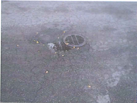
Kuva 3. Sadevesikaivon ympärystän asfalttivaurio pohjoispuolen pysäköintipaikalla.
