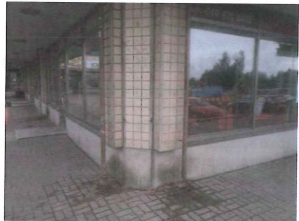
Kuva 4. Kattolipan vedenpoiston syöksytorvien kohdilla torikiveykset ovat painuneet ja sokkelien pinnat ovat värjäntyneet.
