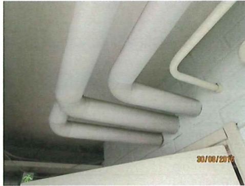
Kuva 6. Putkistoeristeitä mineraalivilla päällystetty muovilla.
