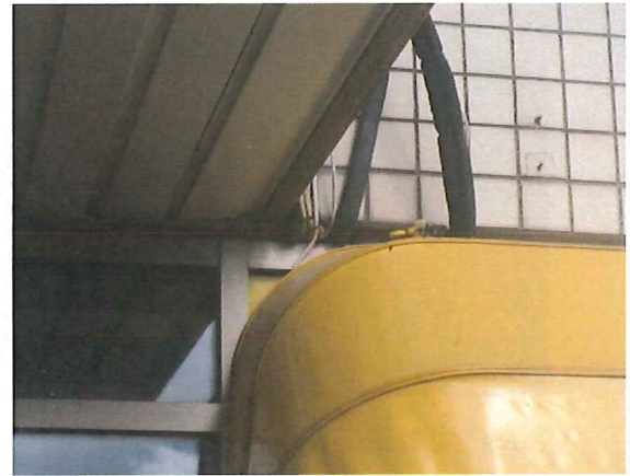
Kuva 20. Koti Pizzan lämpöpumpun kondensiovedet imeytyvät
