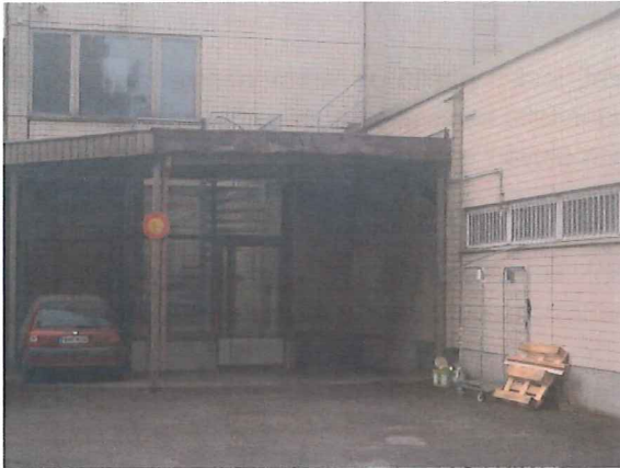
Kuva 17. Sisäänkäynti katoksineen pohjoissivulla. Katoksen reunapellitys on vaurioitunut.
