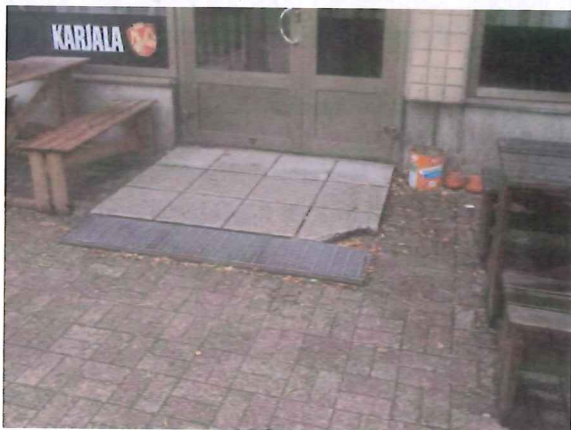
Kuva 5. Betonilaatta on rikkoutunut ravintola Tesoman Pikkuisen edessä – torikiveyksen kallistukset ovat kohdalla hyvät
