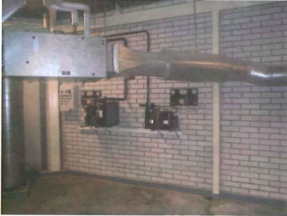
Kuva 29. Teknisen tilan tiiliseinä, jossa on tärinää aiheuttamia kompressoreja.
