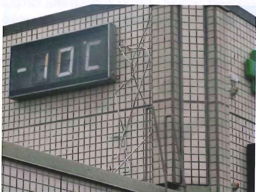
Kuva 5. Johdotuksia mainosvaloille. Toimimaton katseenvangitsija.
