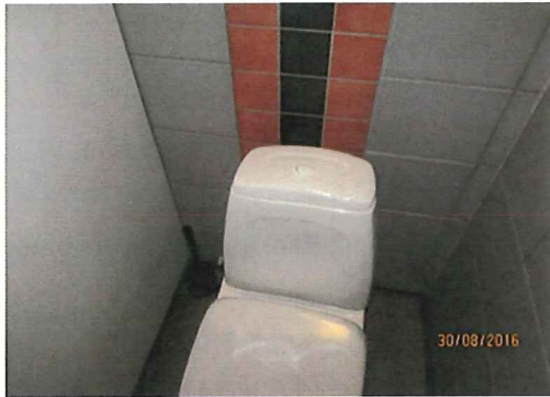
Kuva 7. WC-pytty liiketilöjen saniteettitiloista.
